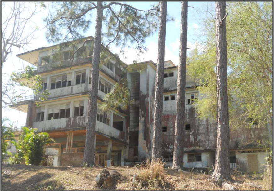
Arriba: vista del hospital antituberculoso cuando se levantaba la tercera planta (1954-1955). Abajo: vista actual del hospital que permanece en ruinas.
